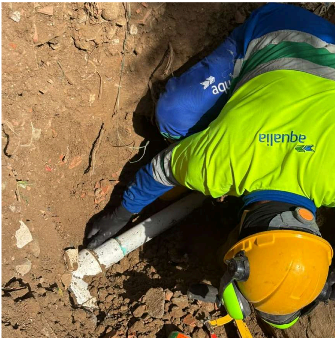
Aqualia detectó conexión irregular de agua en Montevideo I, en Villa del Rosario. Foto: Aqualia.
