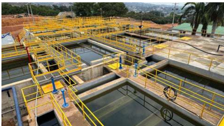
Captación de agua potable en Villa del Rosario
